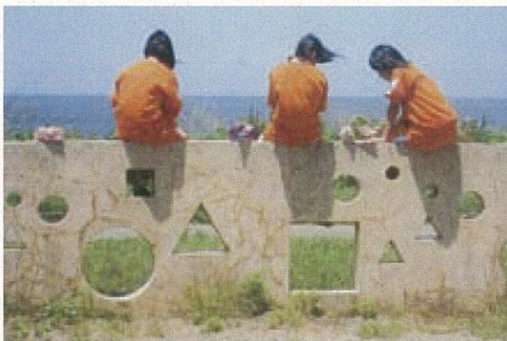
コンクリート構造物のひび割れ模様(新潟海岸)
