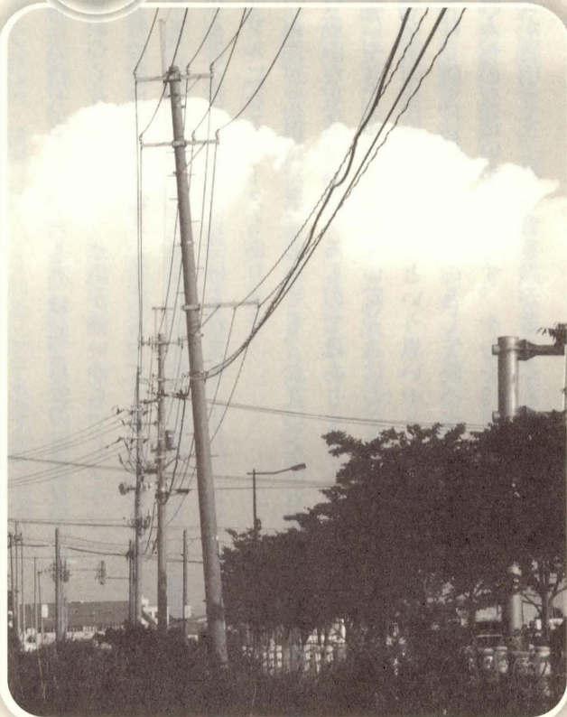
軟弱地盤による電柱の傾き
